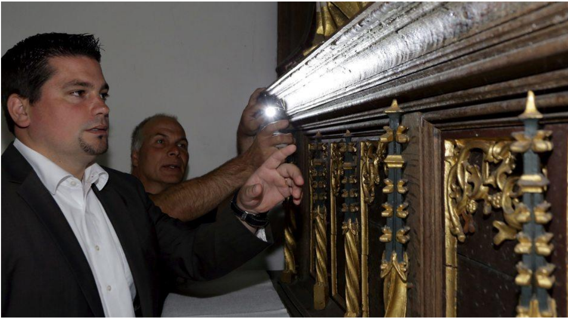
Verwaltungsreferent Tobias Faasen und Johannes Schubert sehen sich die Stellen mit Schimmel an. Foto: Fischer, Armin (arfi)
